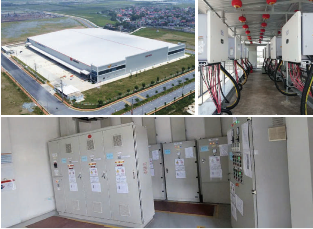
17/ DỰ ÁN: ETEK POWER ĐẦU TƯ BÁN ĐIỆN CHO NHÀ KHO QUY MÔ 1400 KWP - CNC HÀ NAM
